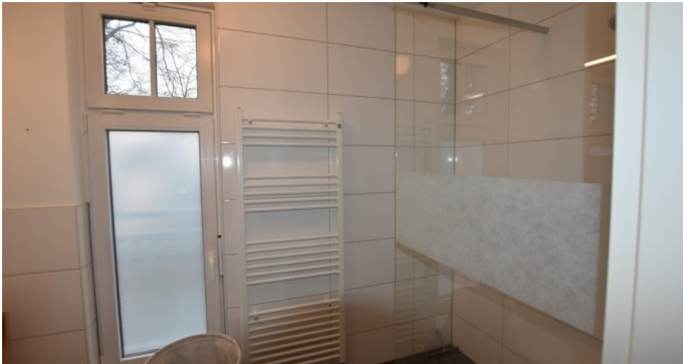
OG Koppelzimmer Bad
