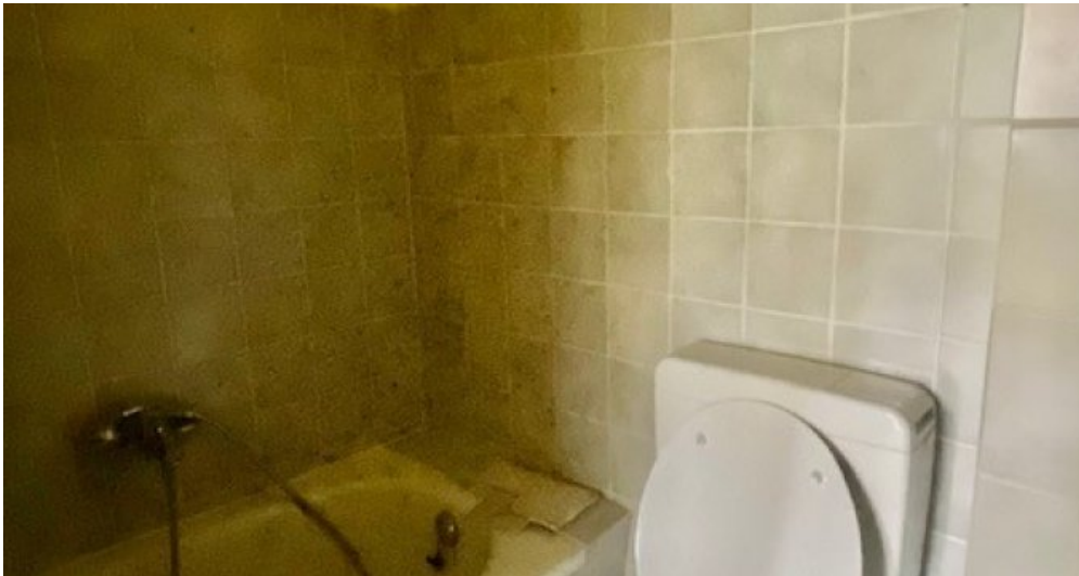
Kanal 13 Bad weitere Ansicht
